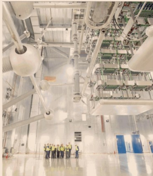
Interconnessioni. La sala valvole della stazione di Cepagatti da dove si snoda il nuovo cavo con il Montenegro
