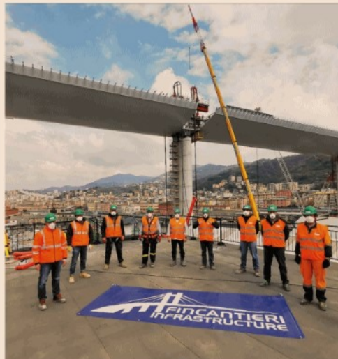
Costruzione e gestione. Inso porterà in dote a Fincantieri Infrastructure anche la manutenzione di grandi edifici
