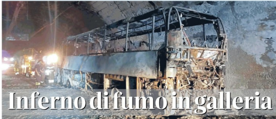
Quel che resta del pullman che ha preso fuoco nella galleria Giugo, all'altezza di Nervi, sulla A12. Pesanti danni anche per la struttura del tunnel MARCO FABIANINI / PAGINE 2 E 3
