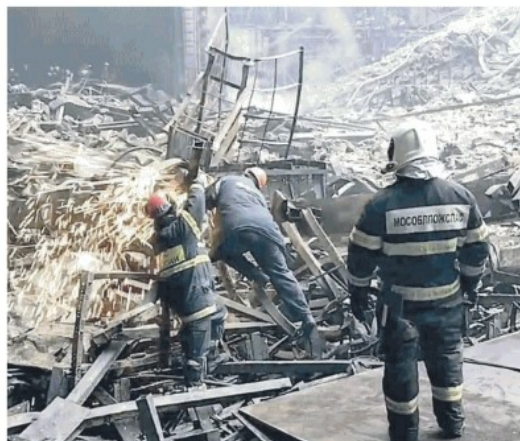
I vigili del fuoco moscoviti al lavoro tra le macerie della sala concerto dopo l'assalto dei terroristi
