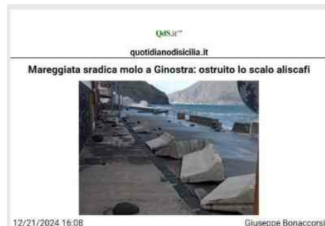
12/21/2024 16:08 Giuseppe Bonaccorsi A Ginostra la violenta mareggiata di ieri ha sradicato un tratto di molo. Due blocchi di cemento del pontile hanno ostruito lo scalo aliscafi. Piove sul bagnato a Ginostra. Dopo i continui eventi calamitosi dei mesi scorsi, tra i quali la caduta copiosa di cenere, le alluvioni, adesso anche due blocchi di cemento del pontile hanno ostruito lo scalo aliscafi della frazione dell'isola di Stromboli. La violenta mareggiata che si è abbattuta ieri sera sulla frazione ha letteralmente sradicato un tratto di molo che, ironia della sorte (come si vede nella foto) è andato a posizionarsi sulla banchina in ferro dello scalo dei mezzi marittimi, ostruendo la possibilità per gli aliscafi di approdare. Dell'episodio sono stati subito informati la Protezione civile comunale e l'amministrazione di Lipari. Sembra che come prima soluzione l'amministrazione del sindaco Riccardo Gullo abbia provveduto ad affidare i lavori di rimozione dei due pesanti blocchi a una ditta di Barcellona Pozzo di Gotto che si trova sul posto per alcuni lavori, che al più presto dovrebbe studiare come rimuovere i due pesanti macigni di cemento. Se l'impresa avrà difficoltà allora si studierà come inviare sulla frazione di Stromboli un mezzo meccanico con gru che consentirà di spostare i due pesanti massi. Ovviamente queste operazioni richiederanno dei giorni. Appare evidente che l'approdo dei mezzi veloci al porto al momento non potrà avvenire. Bisognerà capire se queste operazioni saranno possibili prima dell'arrivo del Natale oppure saranno effettuate subito dopo. Una volta rimossi i due blocchi bisognerà effettuare un collaudo della banchina in ferro per capire se la mareggiata e soprattutto i due macigni di cemento ne abbiano danneggiato la staticità. Ci si augura che l'inconveniente non abbia danneggiato la struttura perché, altrimenti, il ripristino delle normali condizioni di
