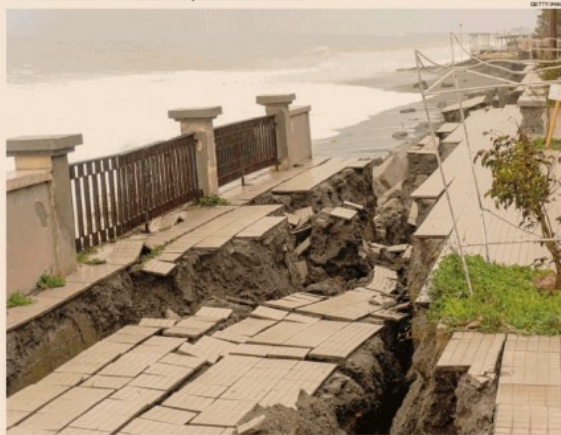
Danni da maltempo. Il lungomare di Melito di Porto Salvo (Reggio Calabria) distrutto dalle recenti mareggiate
