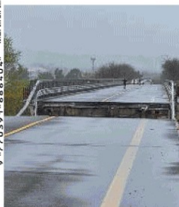
Il crollo del ponte sul Trigno
