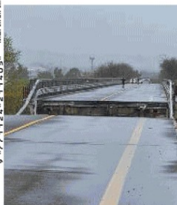
Il crollo del ponte sul Trigno
