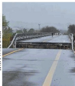
Il crollo del ponte sul Trigno
