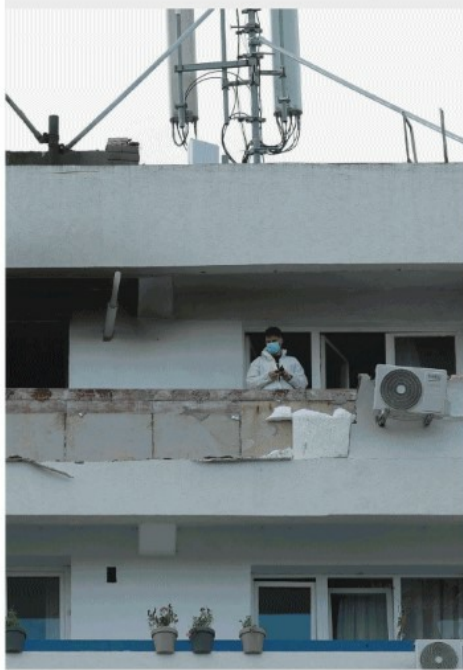
Le ispezioni sull'edificio danneggiato da un drone a Galati SERVIZI / PAGINE 2 E 3
