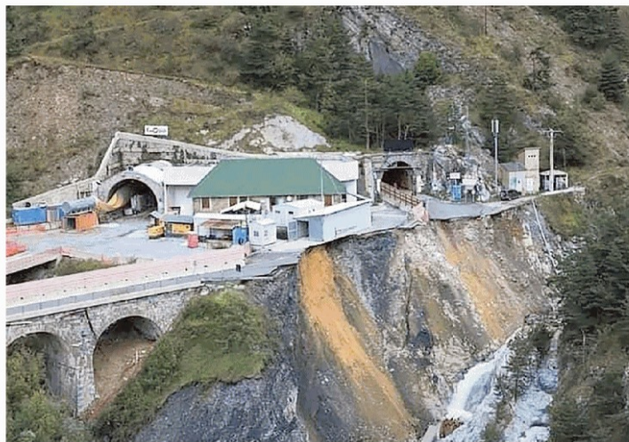
La strada che si collegava, sul versante francese, al tunnel del Col di Tenda è completamente sprofondata
