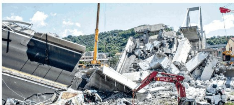
▲ Genova La rimozione delle macerie dopo il crollo del Ponte Morandi
