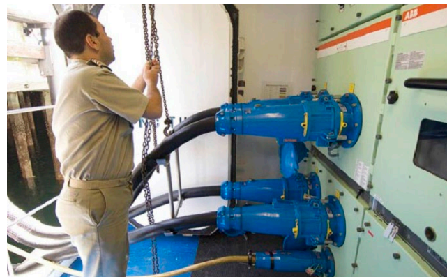
Le imponenti prese dei cavi elettrici onshore collegate a una nave.
